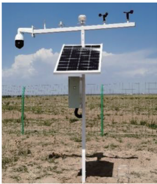
图 17 边缘端数据采集模块实物 Fig. 17 Physical edge end data acquisition module
