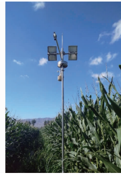
图 3 试验区安装的 CTMS-On line 型作物冠层温度及环境因子测量系统
