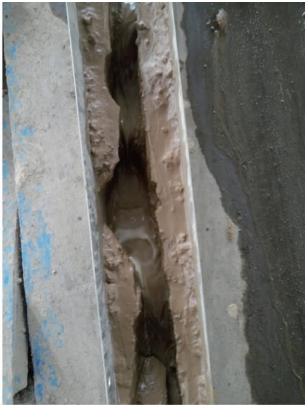
图 4 水流冲刷形成的跌坎 Fig.4 Head cuts scoured by water flow
